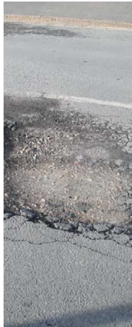
Pavimento asfáltico sobre solo expansivo.
