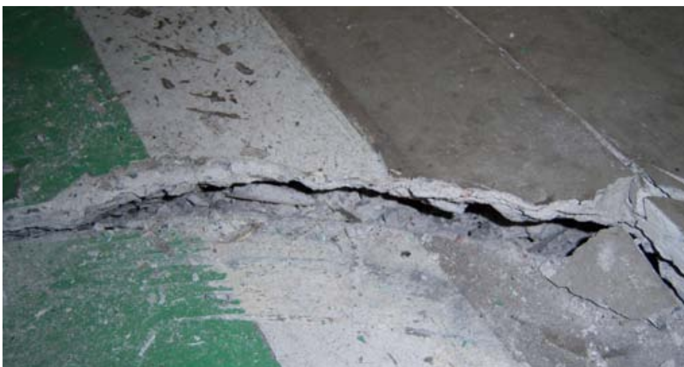
Perdas de resistência do solo, motivaram o fraturamento do pavimento do concreto.
