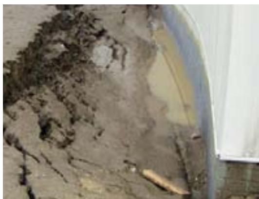
Ruptura de parede de fundação devido ao "efeito de uma bacia argilosa" do aterro.
