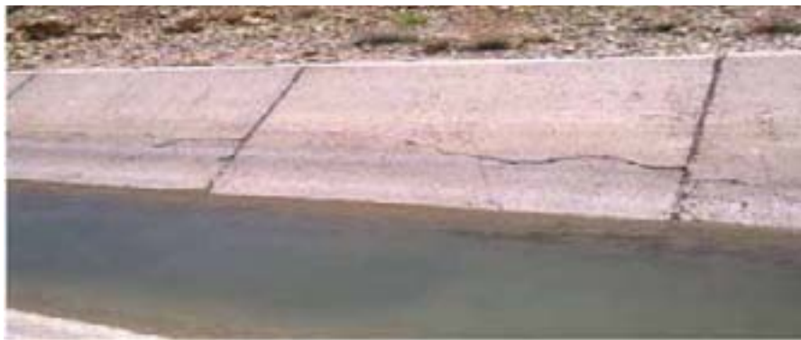
Trincas nesta calçada de concreto provocadas por processo de expansão no solo.
