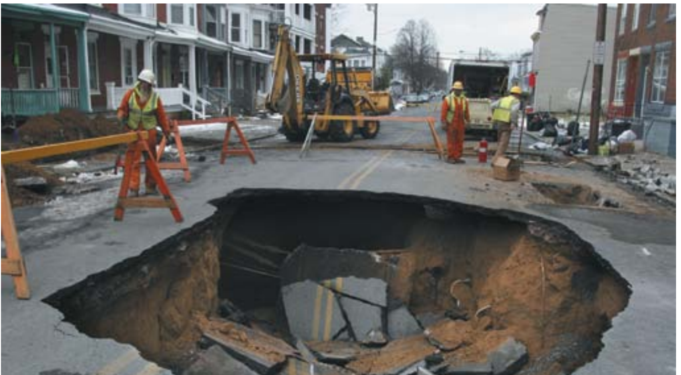
Colapso do solo, motivado por ação localizada da água.
