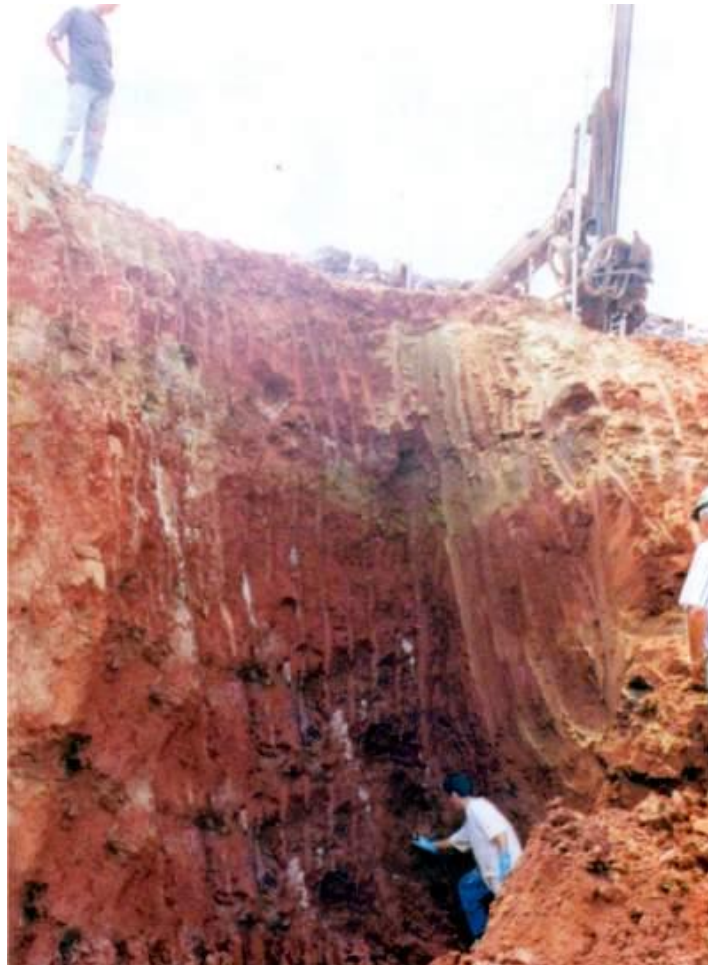
Legenda: Onde havia, anteriormente, infiltrações e o saturamento do solo e rocha há apenas sinais de grout químico. Diversas situações de erosão, da ordem de 15cm de diâmetro, provocada pelo fluxo/permeabilidade da água foram totalmente preenchidas pelo grout químico, principalmente devido ao seu grande processo de expansão.
